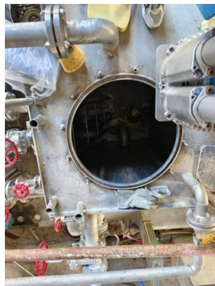
现场照片 2：事故现场润滑机油箱人孔图
