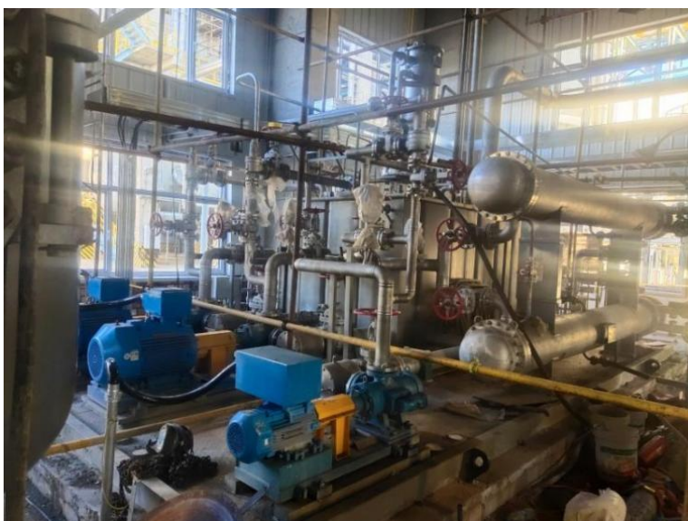
现场照片 1：事故现场润滑机油箱整体图
